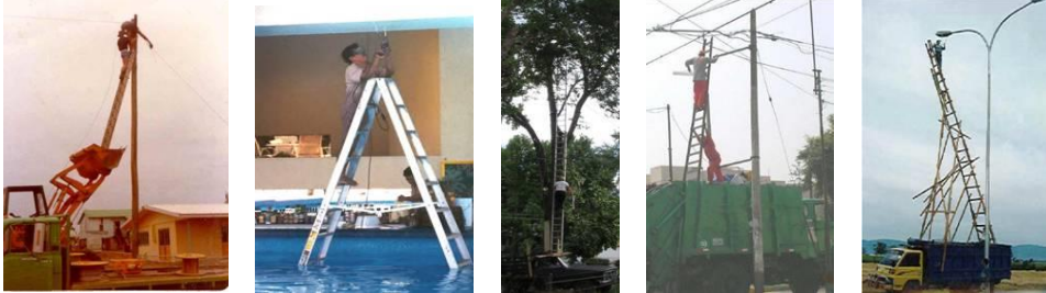
Merdiven Kullanımı İle İlgili Hatalı Uygulamalar
